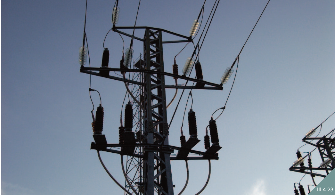
Torre de alta tensión
