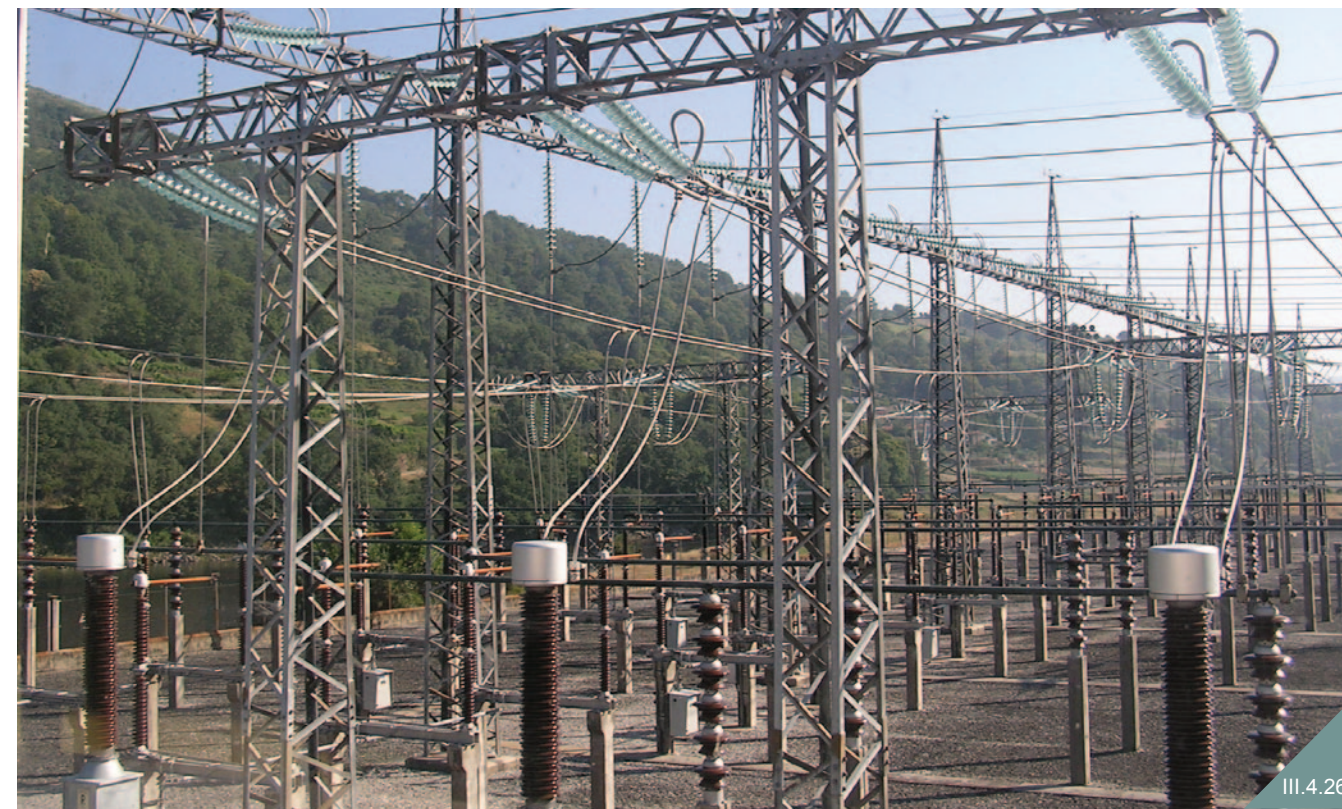
Subestación eléctrica de transporte
