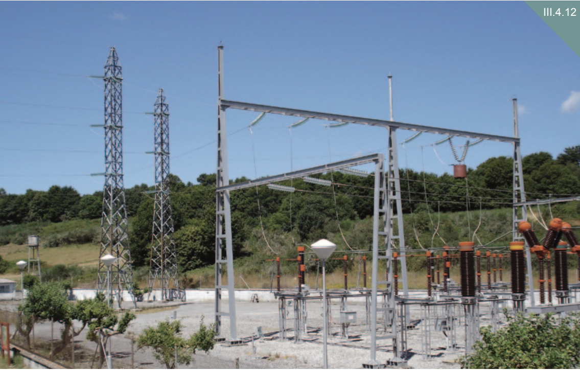
Subestación de distribución
