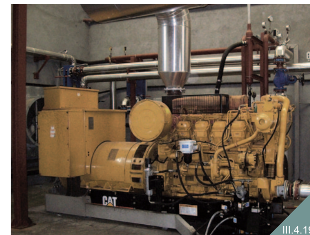
Instalación de coxeración
