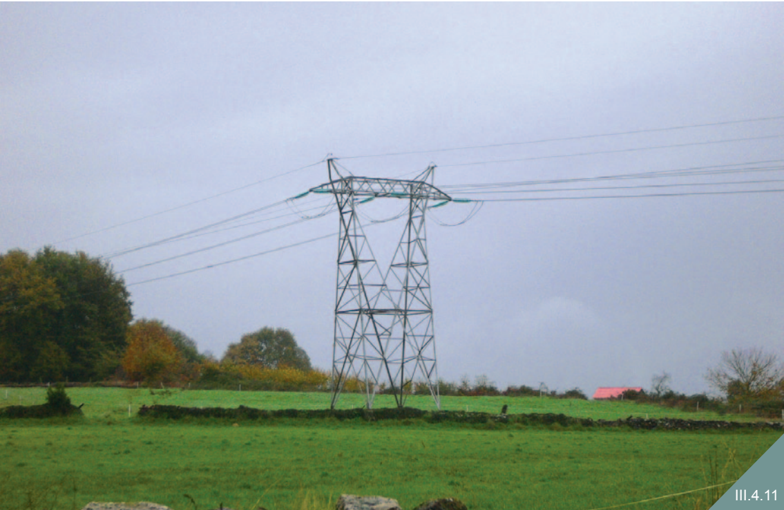
Línea de distribución
