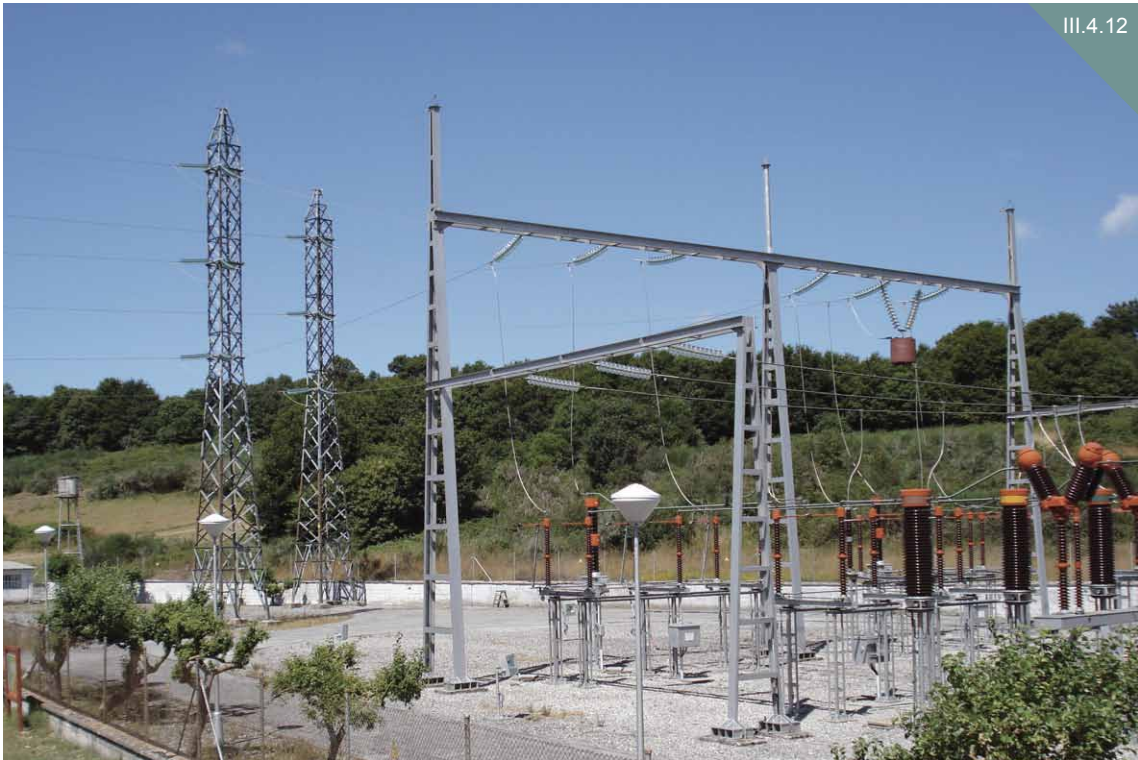
III.4.12 Subestación de distribución.
