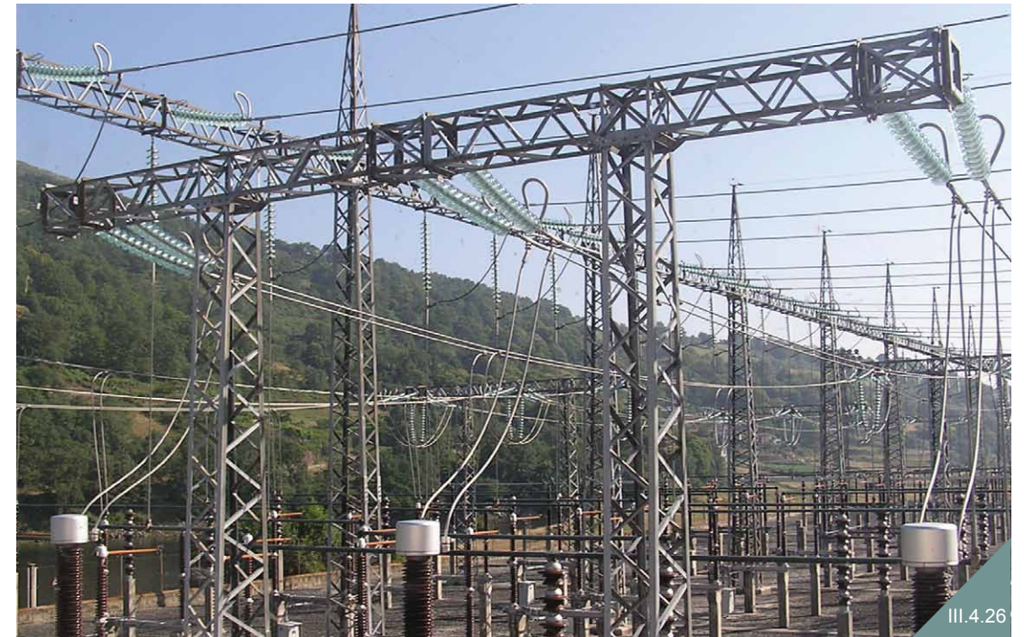
III.4.26 Subestación Eléctrica de Transporte.
