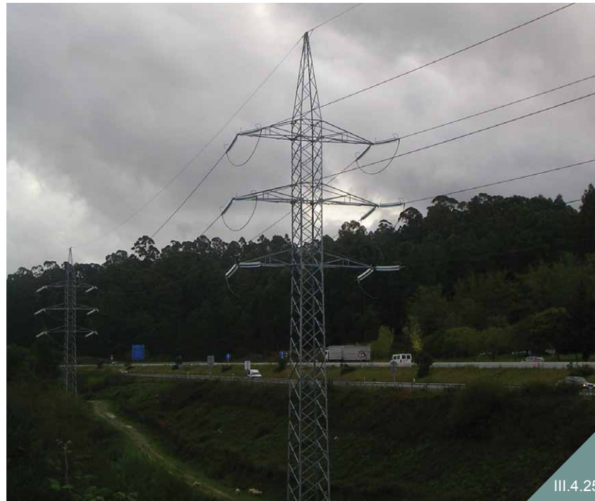
III.4.25 Liña de Alta Tensión en paralelo con infraestrutura viaria, na provincia de Pontevedra.
