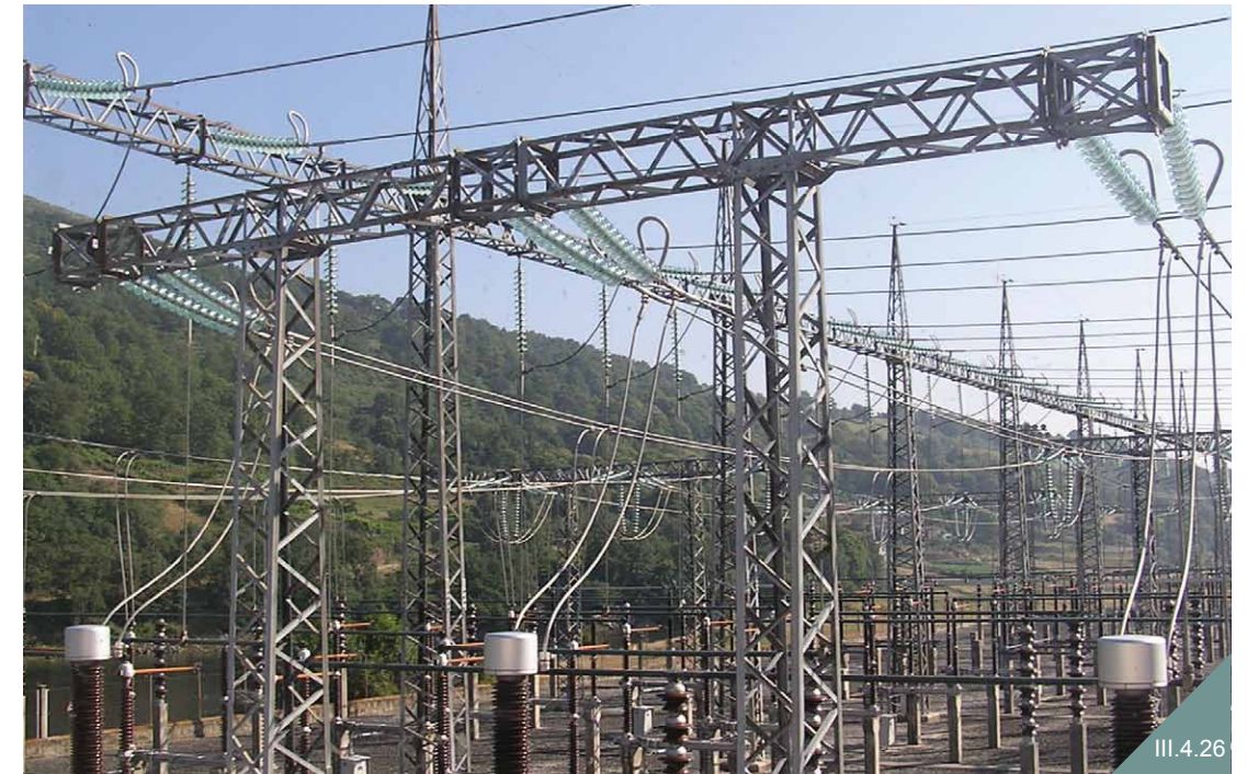
III.4.26 Subestación eléctrica de transporte.
