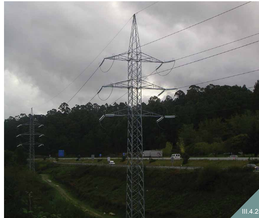
III.4.25 Línea de alta tensión en paralelo con infraestructura viaria.
