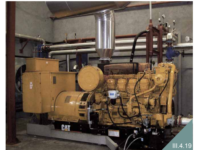
III.4.19 Instalación de cogeneración.
