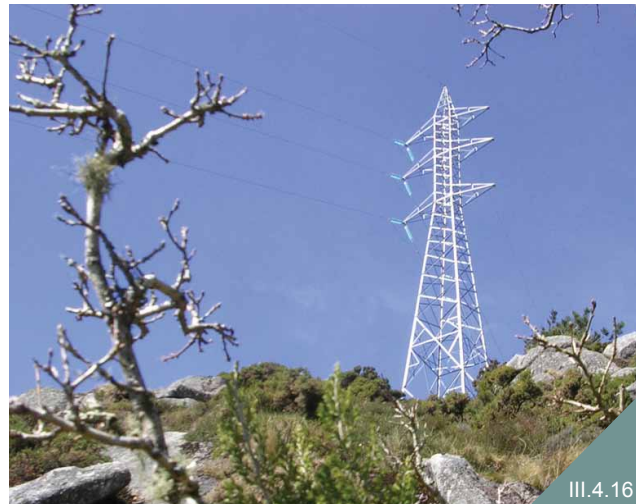
III.4.16 Línea eléctrica de alta tensión, en el norte de la provincia de Lugo.
