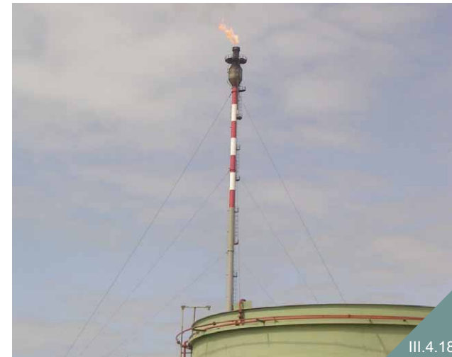
III.4.18 Chimenea de refinería de Petróleo.
