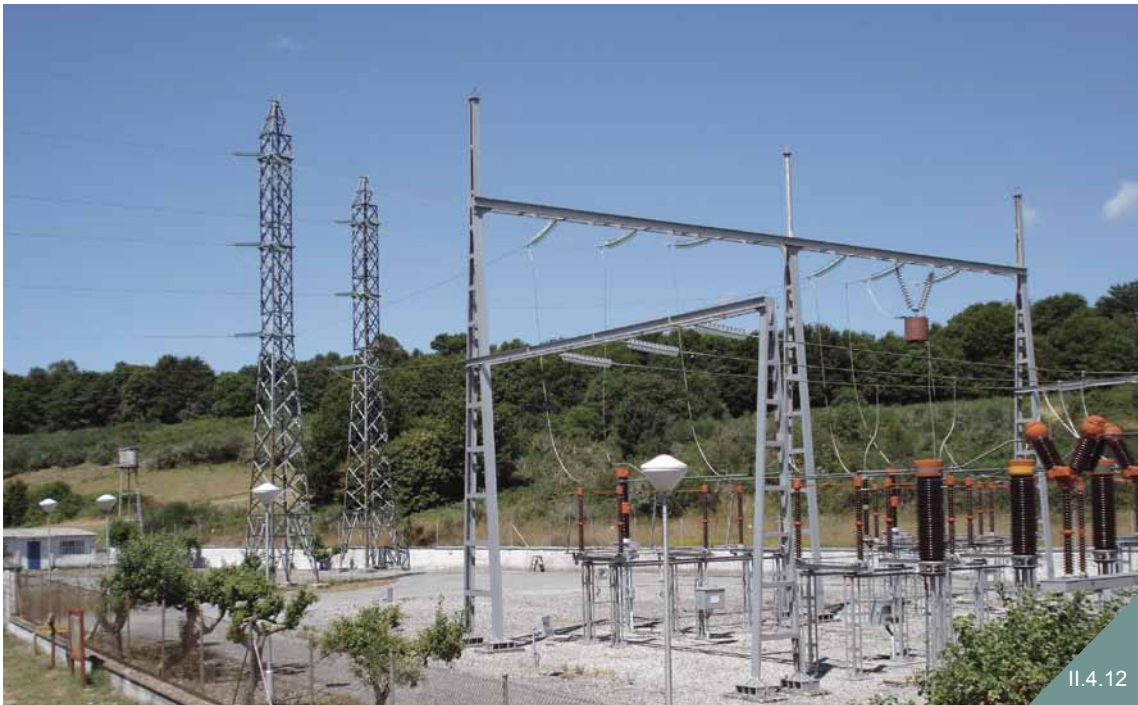
Subestación de distribución.
