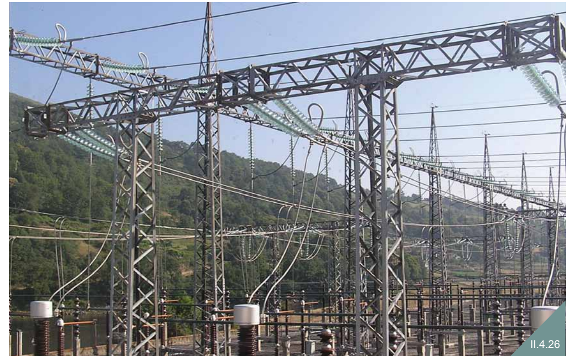
II.4.26 Subestación Eléctrica de Transporte.
