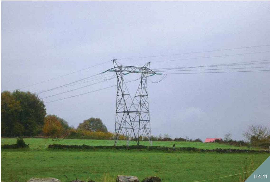
Línea de distribución
