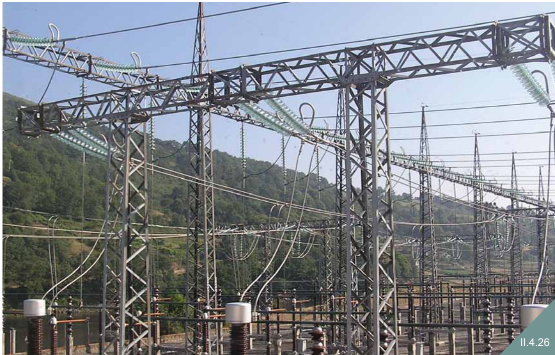
Subestación eléctrica de transporte.
